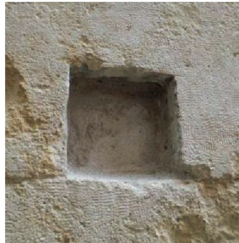
2. Buca puntaia completamente otturata, come misura anti-colombo
